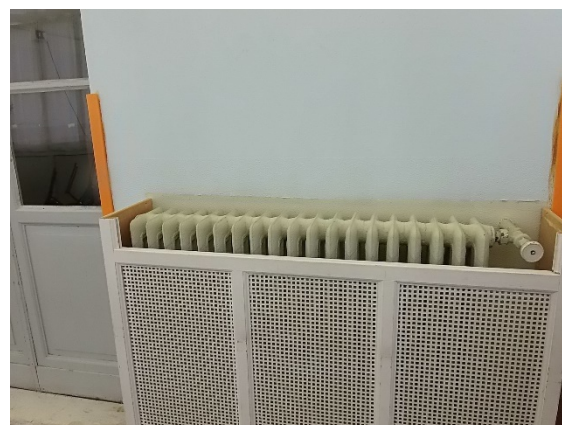
Figura 4.6 - Particolare del radiatore in ghisa senza valvole termostatiche
