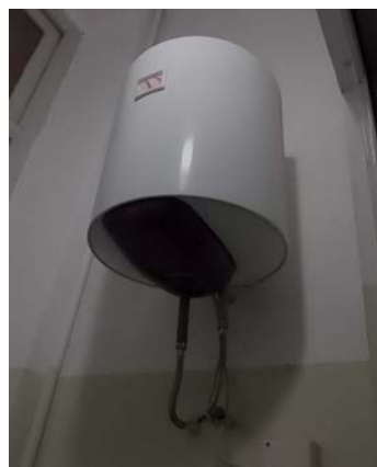
Figura 4.11 - Particolare di un boiler elettrico per la produzione di acqua calda sanitaria – boiler installato in cucina
