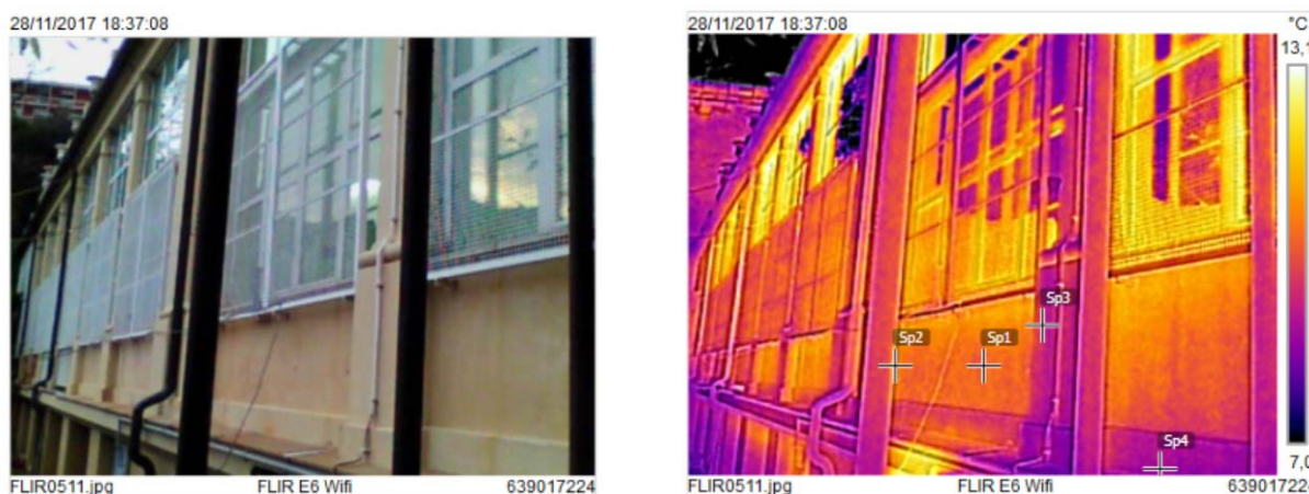
Figura 4.5 – Rilievo termografico dei serramenti del refettorio al piano terra
