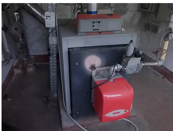
Figura 4.9 - Particolare caldaia a basamento
