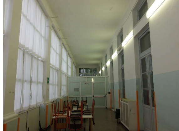
Figura 8.13 - Particolare impianto illuminazione su cui intervenire.
